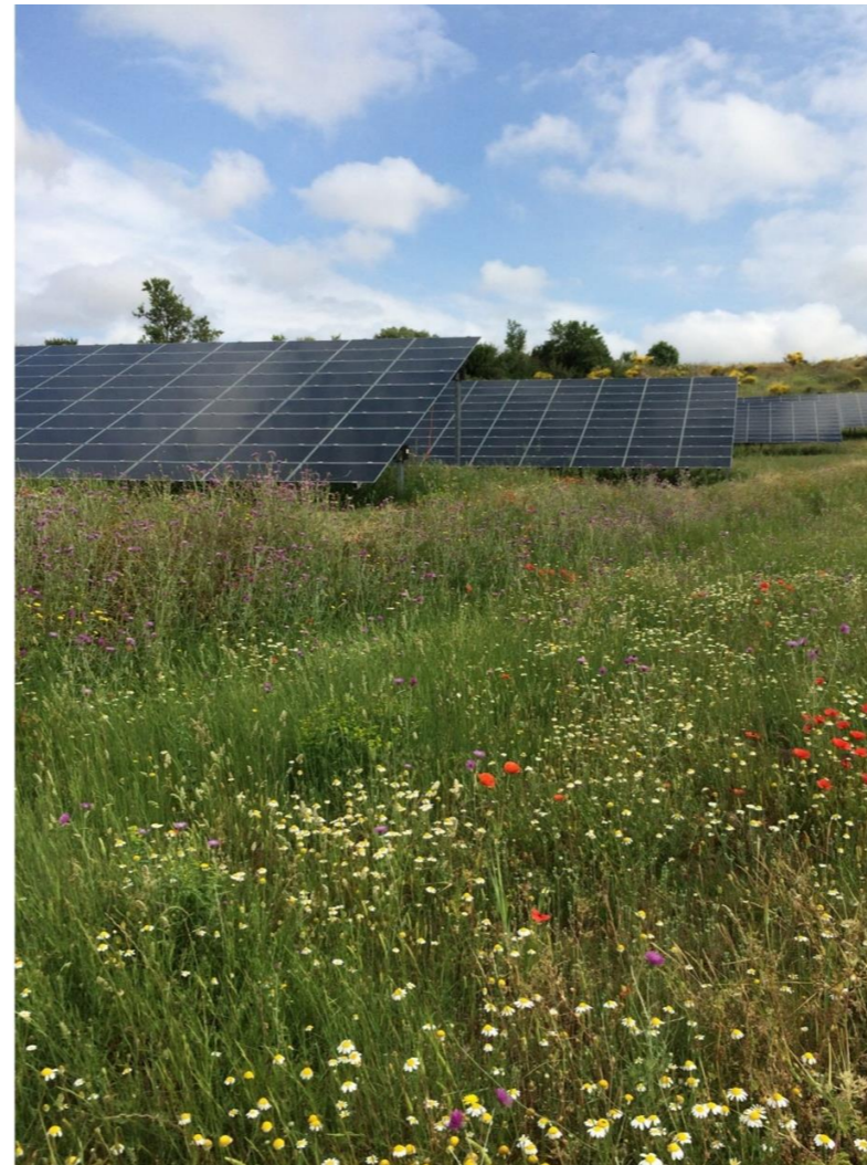
Parc photovoltaïque EDF Renewables de Narbonne (source : EDF Renewables)
